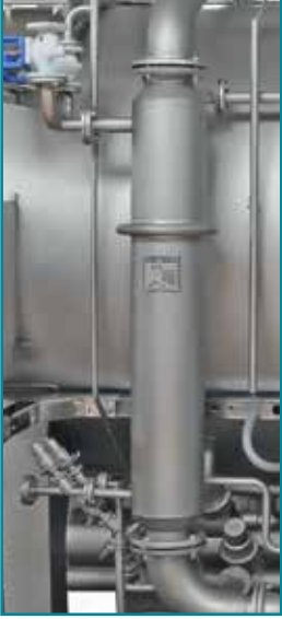
Ana tank ısıtma eşanjörü Main tank heat exchanger
