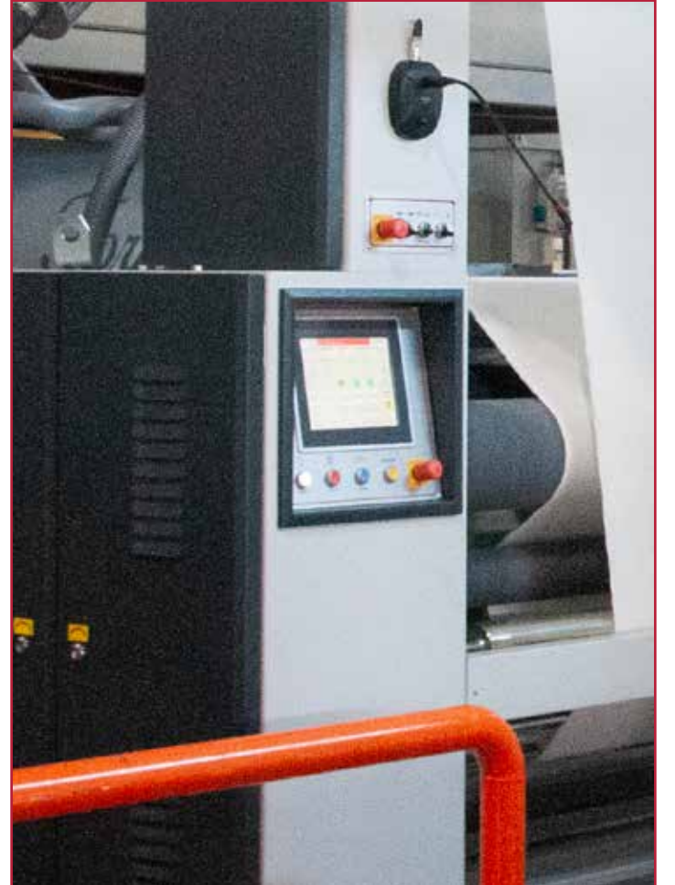
Çıkış Kontrol Sistemi Paneli Exit control panel
