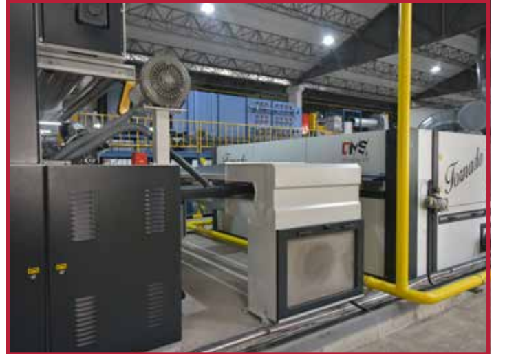
Hava Soğutma Fan Bölümü / Exit Cooling Unit
